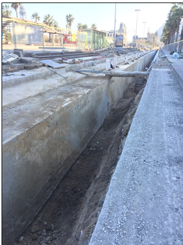
Fotografia 101. Vista general del tram de rasa oberta amb seguiment arqueològic amb la galeria de serveis
