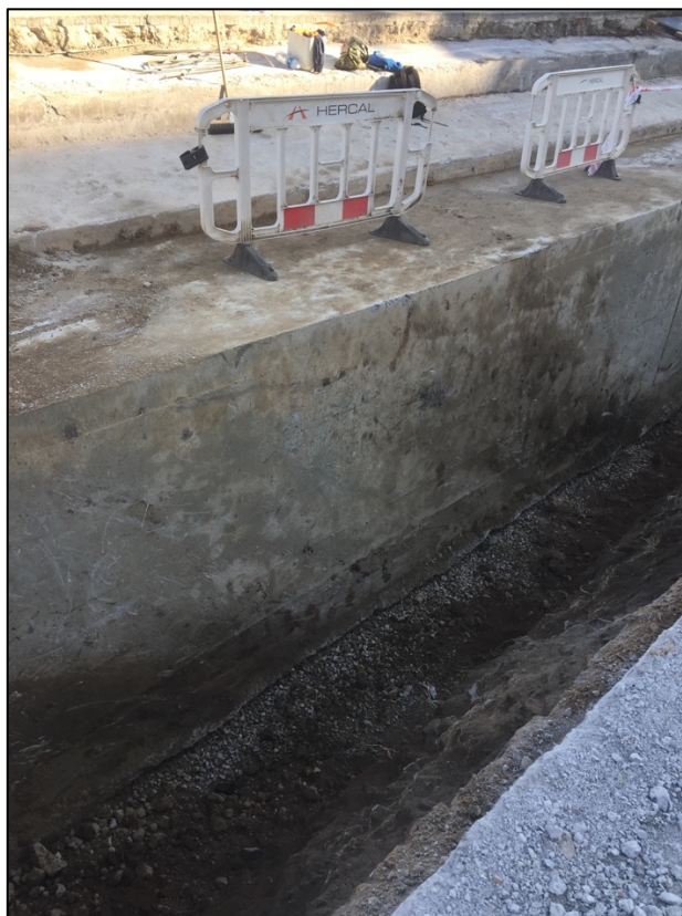
Fotografia 66. Vista galeria de serveis UE1005 un cop oberta la rasa per facilitar els treballs d'impermeabilització.
